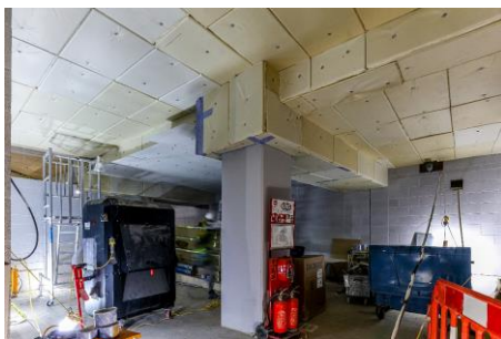
Isolamento delgado, não-combustível no teto de um subsolo na One Nine Elms Street em Londres.
