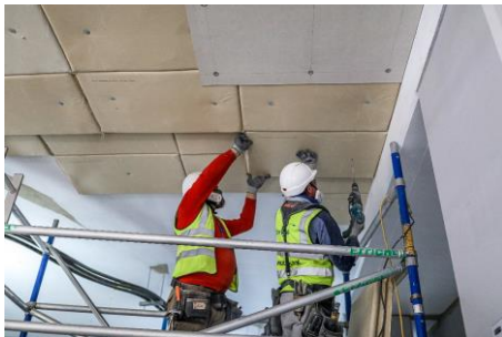
Instalação do CALOSTAT® Pad no teto de um porão (One Nine Elms Street, Londres)
