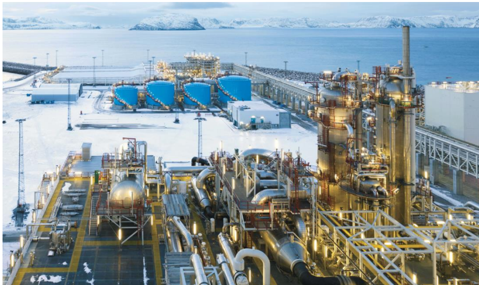
Planta onshore para processamento de gás natural (© The Linde Group).
